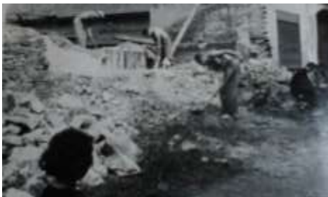
Občané i členstvo místní Jednoty Sokola připravují demolicí starých chlévů v čísle 12 místo pro novou prodejnu Jednoty (r. 1960)
